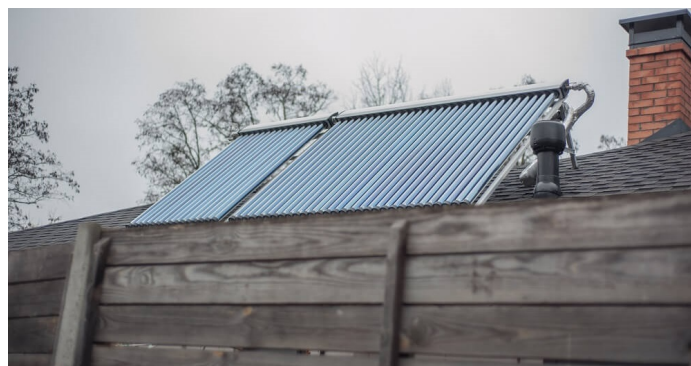
Exemplo de sistema de aquecimento de água termossolar com painéis de tubo a vácuo
